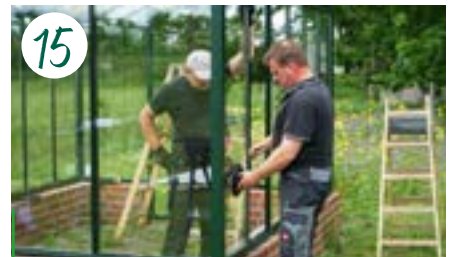
15 Jetzt zur Verglasung: Die Ecken werden immer zuerst verglast – auch im Giebel.
