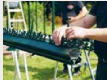
Da das Gewächshaus mit viktorianisch anmutenden Zierelementen versehen wird, werden diese anschließend auf dem Firstprofil verschraubt
