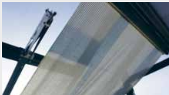
Befestigung, trotz Fensteröffner
