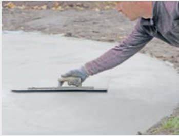
Das fertig gegossene Fundament ist bereit für die Montage des Pavillons Rondo
